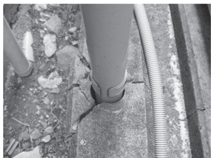
コンクリート割れ
