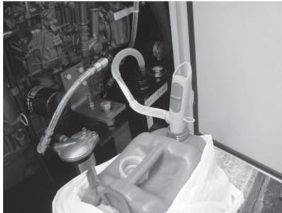
発電機への給油
