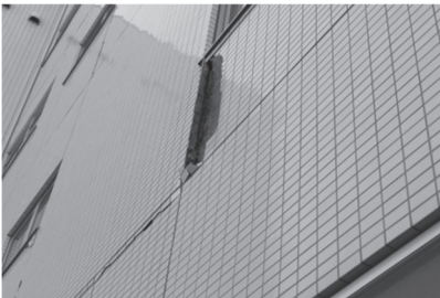
側壁タイル落下
